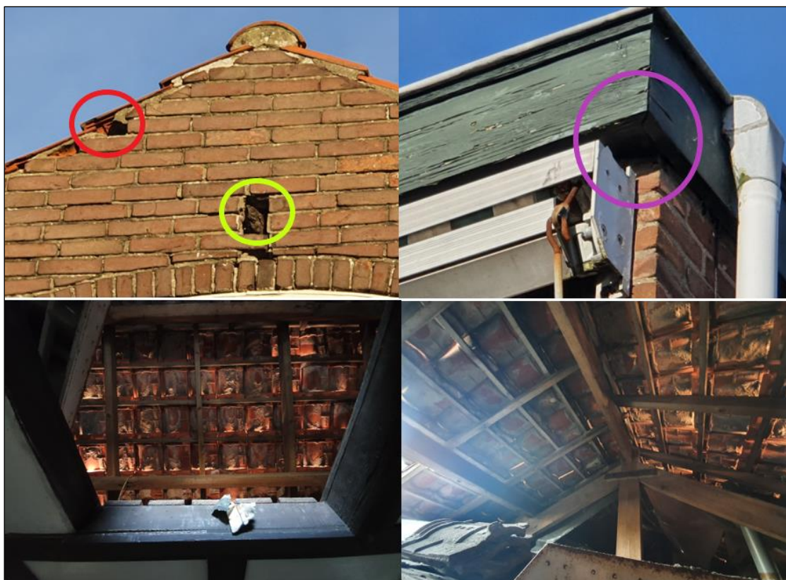
Figuur 5: De opening in de rode cirkel loopt niet door. De opening in de groene cirkel is gevuld met hout, wat vroeger dienst deed als hijsbalk. De dakpannen zijn van binnenuit zichtbaar, er is niet afgetimmerd waardoor er geen ruimte is tussen de pannen en bijvoorbeeld een houten plaat. Er zijn geen sporen gevonden van vleermuizen op de zolder. Bovendien was er ten tijde van het veldbezoek een flinke tocht voelbaar, ondanks dat het slechts windkracht 2 was. Van vleermuizen is bekend dat zij tocht ten alle tijden vermijden en derhalve deze zoldering niet als verblijfplaats gebruiken. Het boeideel in de paarse cirkel is afgetimmerd en sluit aan bij de muur, waardoor er geen openingen zijn naar de achtergelegen ruimte.
